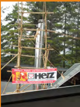
HERZ Energietechnik im fernen Bhutan
